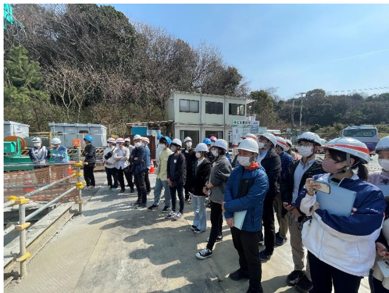
図 5 西部幹線併設水路砥神工区工事現場にて発破を待つ参加者 (写真撮影・掲載許可確認済み)
