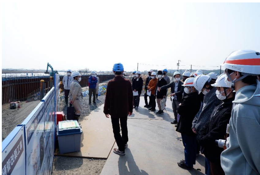
図 1 揖斐川御砂樋管改築工事現場にて説明を受ける参加者 (写真撮影・掲載許可確認済み)
