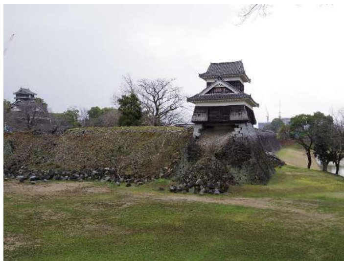
図 3.1.1 地震により崩壊した戌亥櫓の石垣
