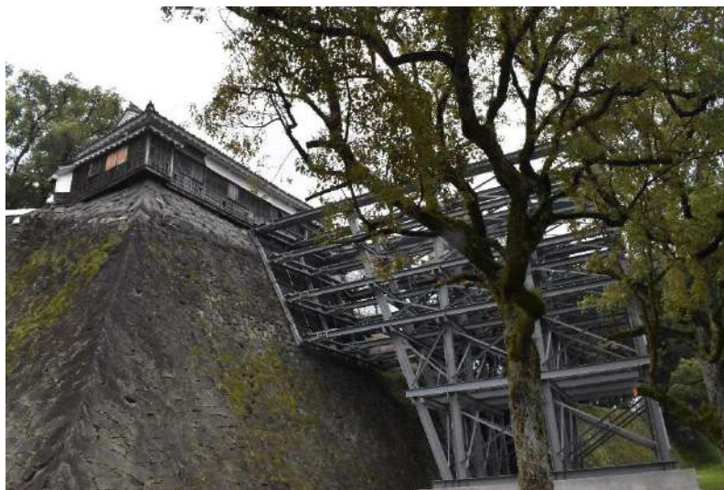
図 3.1.3 石垣を外側から押さえつける大規模な装置
