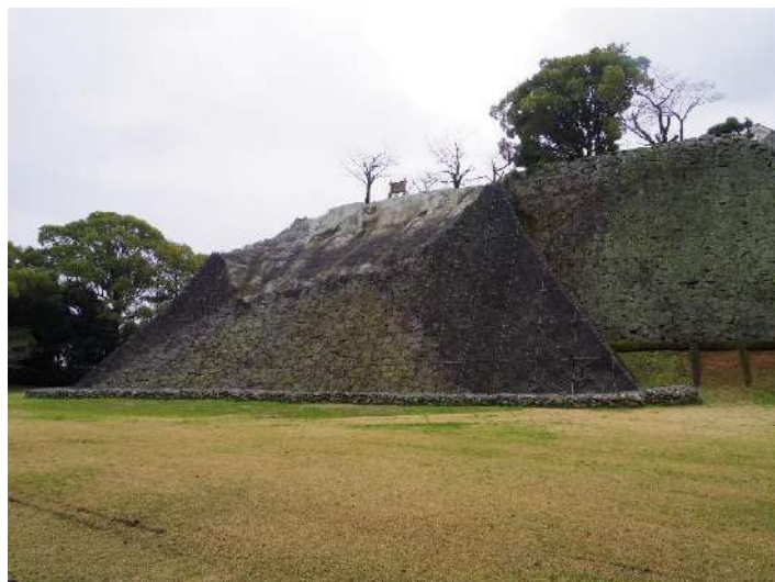
図 3.1.4 北十八間櫓のネットとモルタルで補強された石垣
