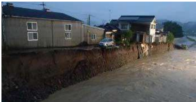
図 13.2 筑後川水系 花月川 堤防の洗堀が発生した様子
