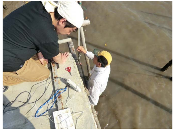
濁度計の設置
