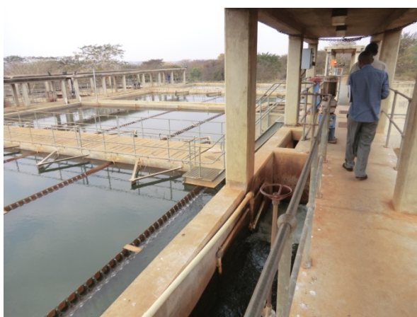
敷地内にある浄水場. 設備レベルは日本に比べると随分と低い.
