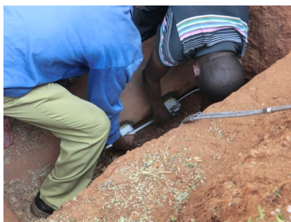
流量調査のため, 水道管が見えるまで穴を掘り, 流量計を設置する.
