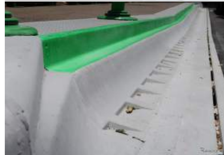
車両を寄せやすくするための縁石
